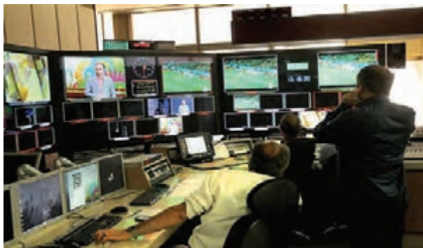
تصویر ۲۹- اتاق فرمان کنترل پخش
